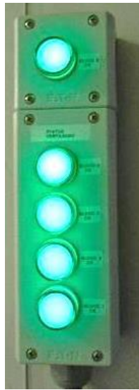
Figura 17: Sensor utilizado para identificar e emitir sinal luminoso para detecção de falhas no sistema de ventilação.
