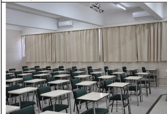
Figura 28 – Ar condicionado instalado nas salas de aula – Câmpus 1
