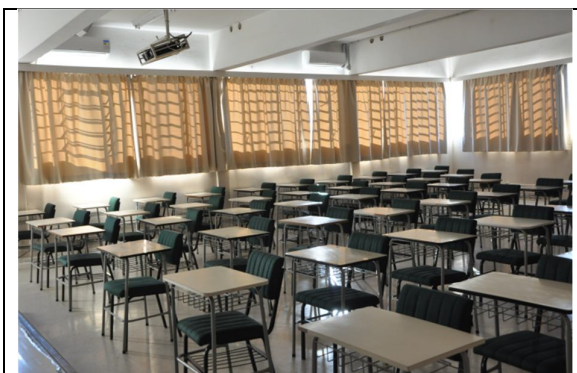
Figura 29 – Ar condicionado em sala de aula – Câmpus 1
